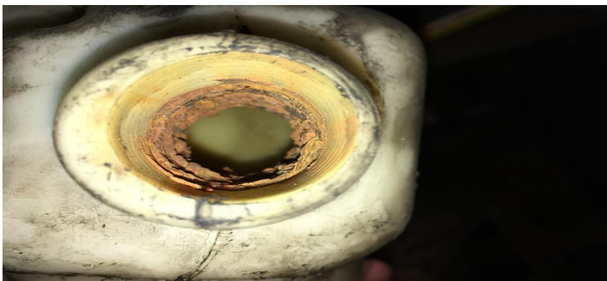
Figura 55: Reservatório de expansão com resíduos metálicos
