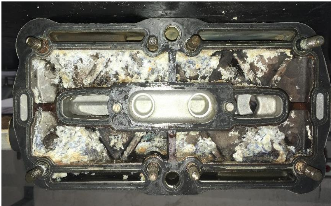
Figura 63: Tampa cabeçote do compressor
