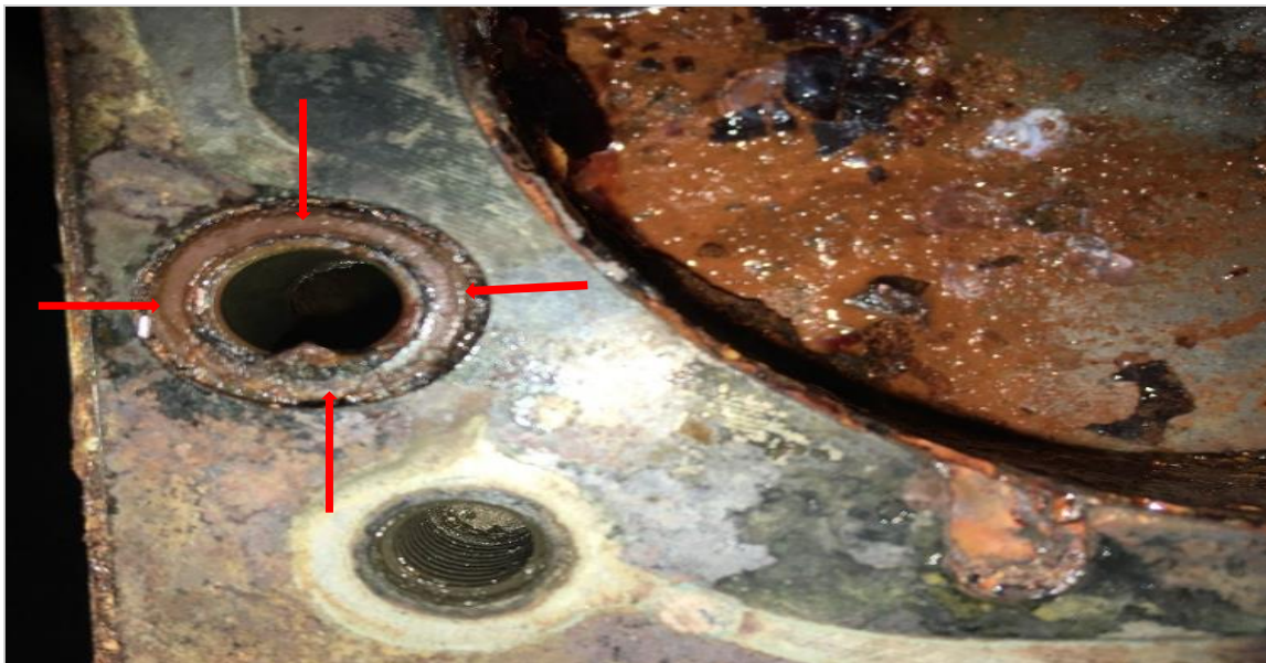
Figura 65: Anel vedação do compressor de ar danificado
