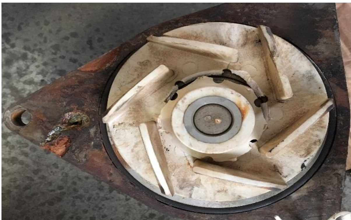
Figura 56: Bomba d'água com pás polimérica quebrada
