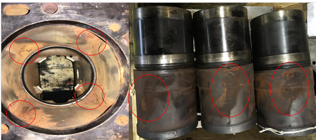
Figura 60: Cavitação bloco do motor e camisas do pistão
