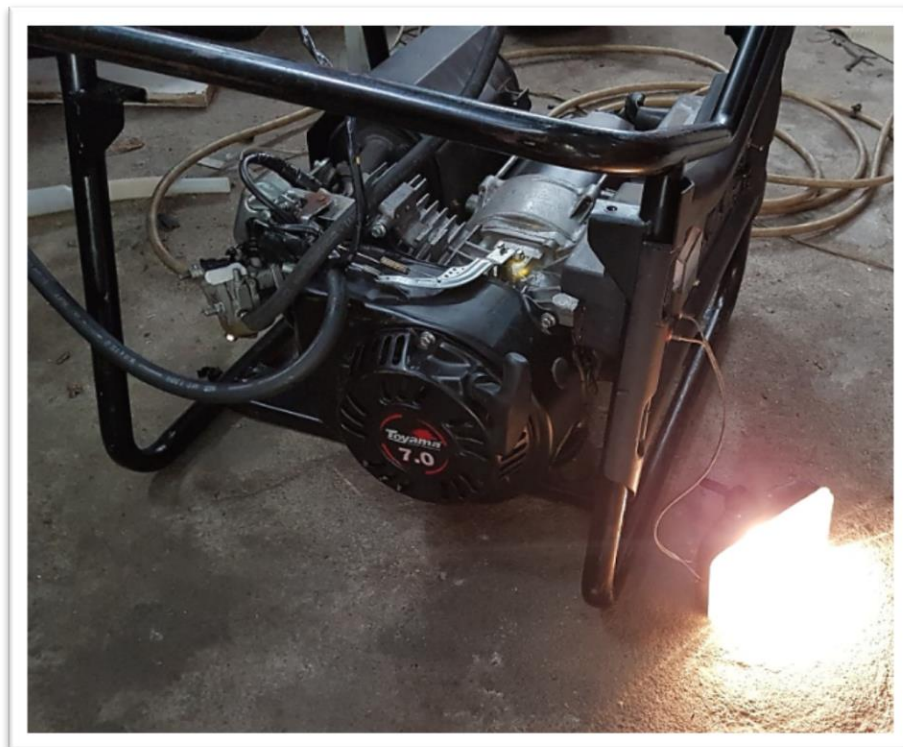
Figura 31 - Fase de Ajustes gerador injetado
