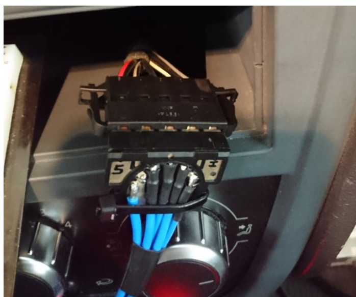
Figura 40 - Conexão das saídas dos reles no chicote original do sistema de climatização.
