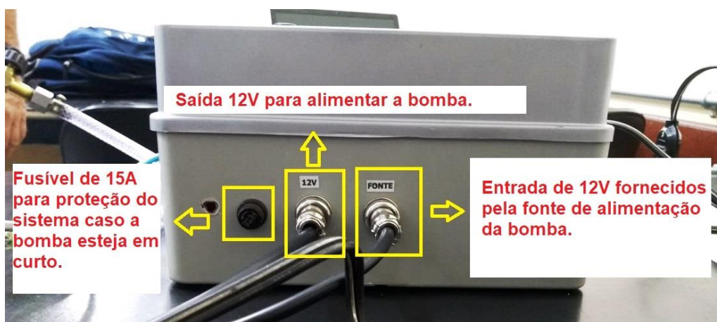
Figura 31: Disposição da alimentação da bomba no painel.
