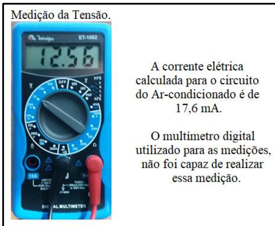
Figura 41- Medições de tensão e corrente elétrica do Ar-condicionado.
